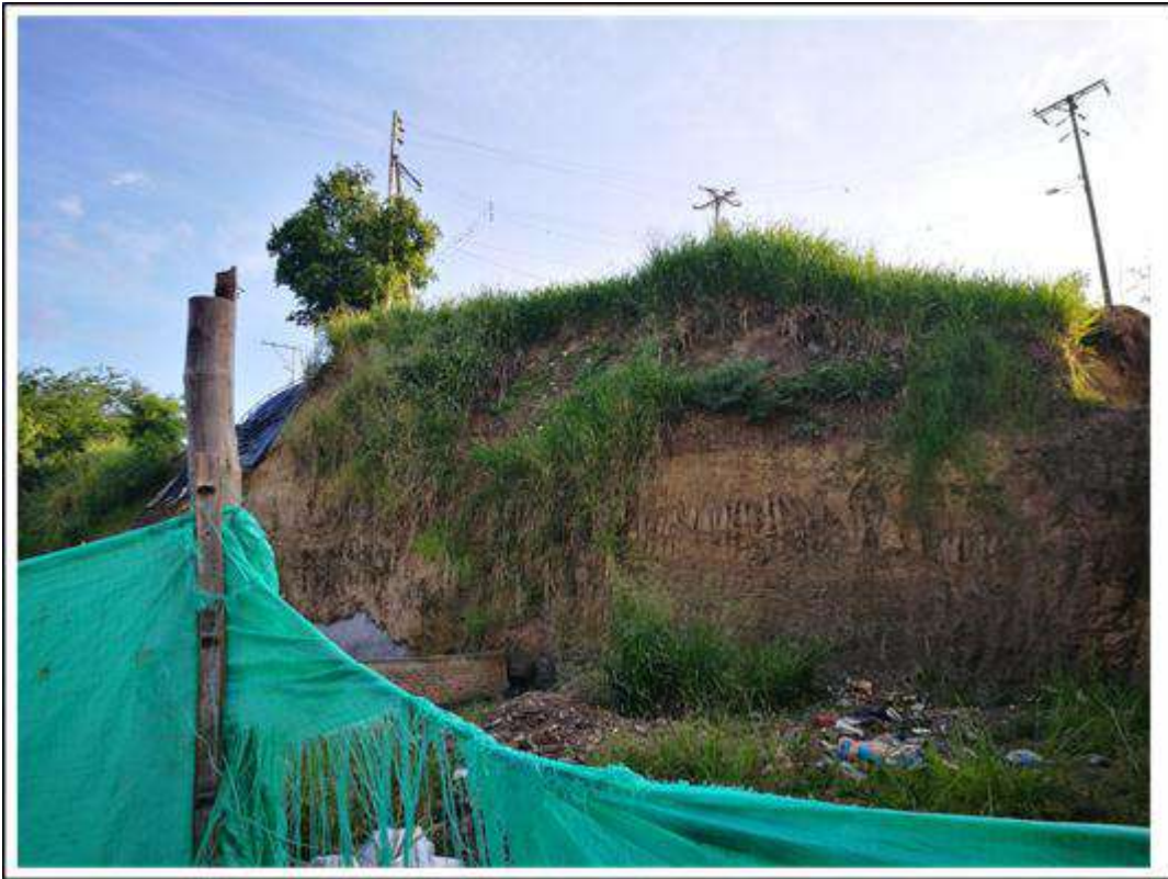
Ilustración 25. Talud generado por construcción de viviendas en el barrio Conquistadores, carente de obras de estabilización, manejo de aguas y cobertura. Elaboración propia.
