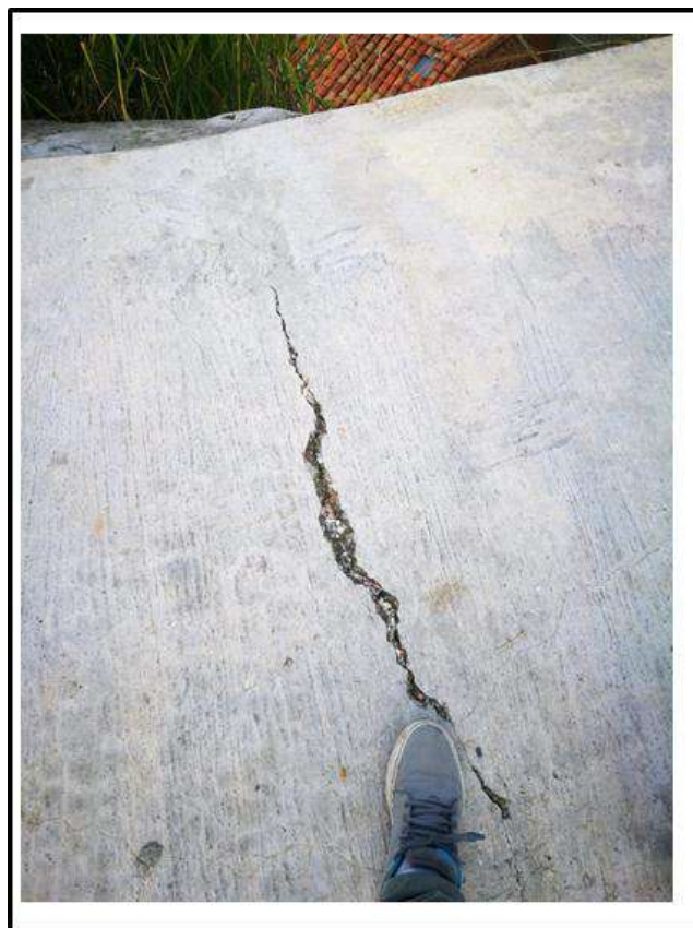
Ilustración 32. Grietas en la parte superior del talud. Elaboración propia.
