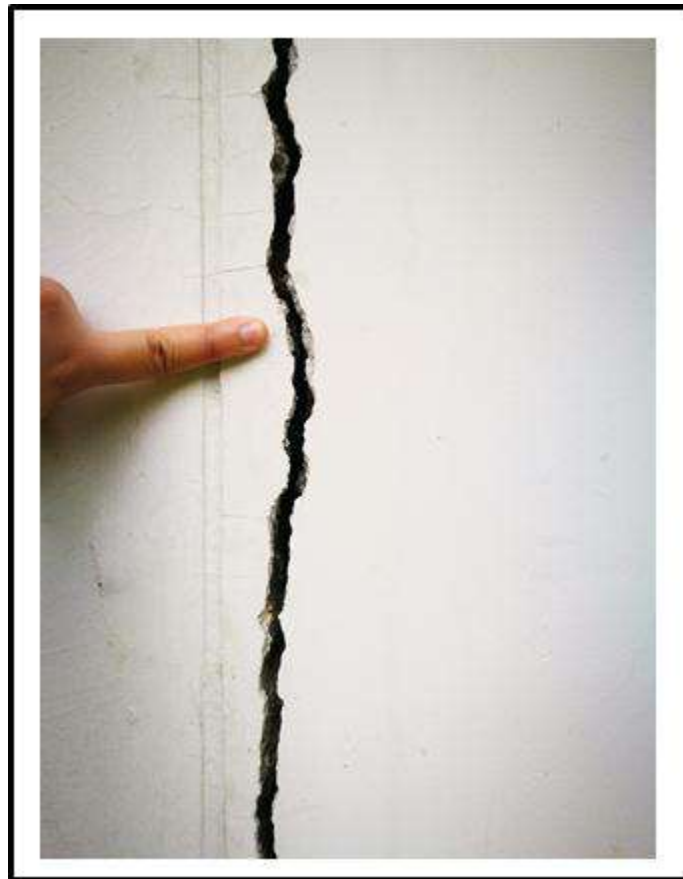
Ilustración 42. Grietas en la estructura de la institución educativa. Elaboración propia.
