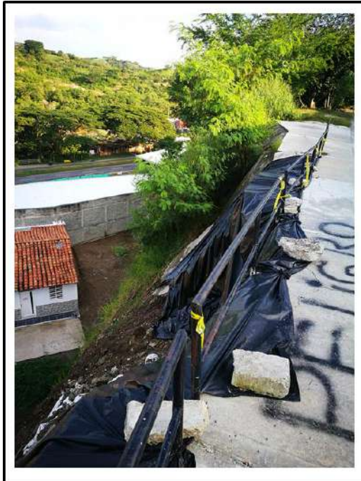
Ilustración 31. Evidencias de proceso de desestabilización, Barrio Conquistadores. Elaboración propia.
