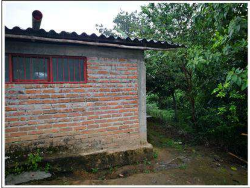
Ilustración 26. Estructuras carentes de sistemas de recolección y conducción de aguas, I.E. Zaragoza, vereda Coloradas. Elaboración propia.
