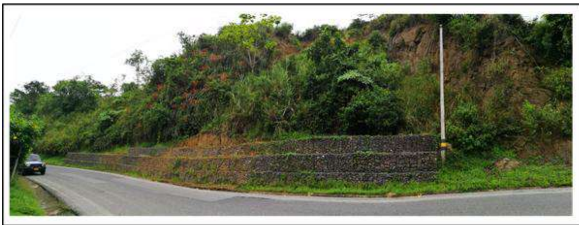
Ilustración 15. Cicatriz de movimiento en masa, sector Piedras de Moler, vía Cartago- Alcalá. Imagen propia registrada durante el trabajo de campo.
