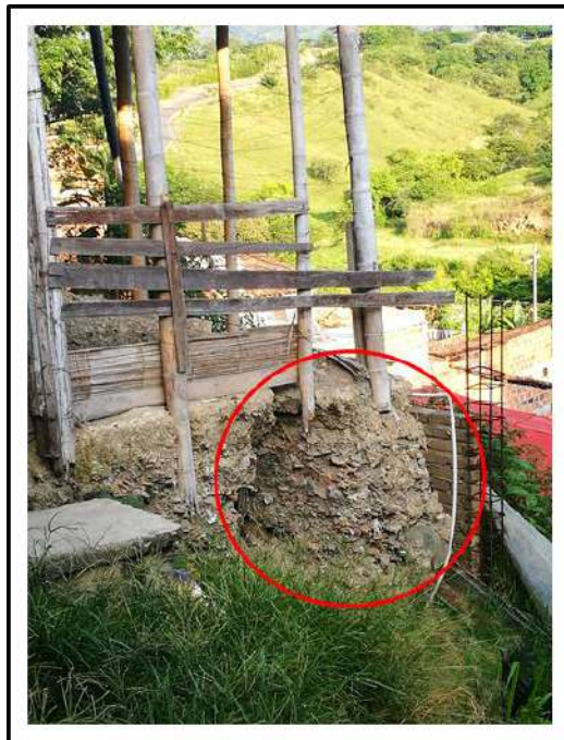
Ilustración 35. Técnicas de construcción poco adecuadas, sobre depósitos antrópicos poco aptos para la construcción. Elaboración propia.
